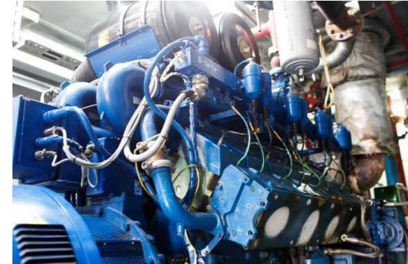
716 kW ele BHKW
